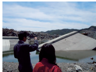
▲押し流された防波堤
